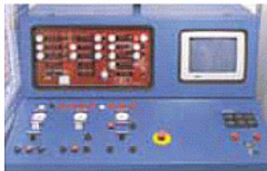
Steuerstand in dem Vortriebscontainer. Hier werden alle für den Vortrieb relevanten Daten angezeigt und aufgezeichnet. Mit den Bedienelementen kann die Kanalhaltung ferngesteuert und zielgenau aufgeföhren werden.
