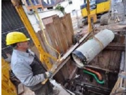
Runter damit: Das neue Kanalrohr wird mit einem speziellen Verfahren verlegt. Foto: Monika Müller
