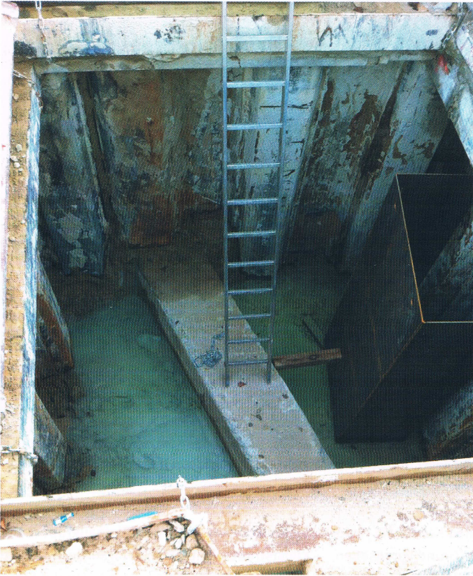
Zielbaugrube Wittekindstraße in Spundwand-Bauweise mit der eingebrachten HDI-Sohle. Zu sehen ist ebenfalls der durchdringende Bestandskanal DN 400 Stz mit einer Betonummantelung (mittig) sowie dem Einfahrkasten (rechts), der mit einer Tonabdichtung für den Einfahrvorgang versehen wird. | Foto: Stadtwerke Osnabrück
