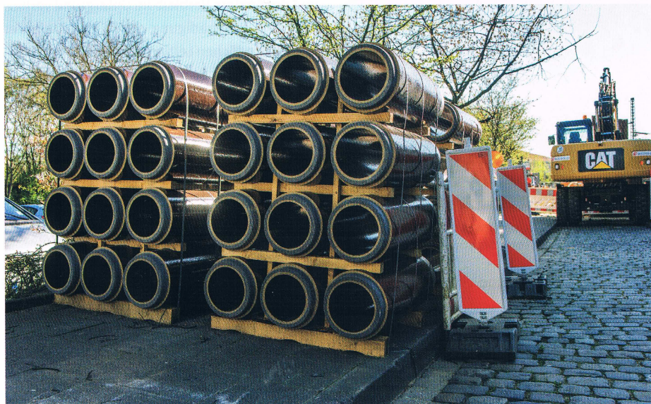
„Rohr frei“: Die neuen Vortriebsrohre DN 250 Stz (Steinzeug) warten auf ihren Einsatz im Osnabrücker Untergrund | Fotos: Stadtwerke Osnabrück
