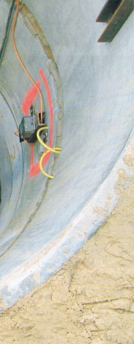
Absenkschacht DN 2000 als Startbaugrube für den Vortrieb in zwei Richtungen | Foto: Stadtwerke Osnabrück
