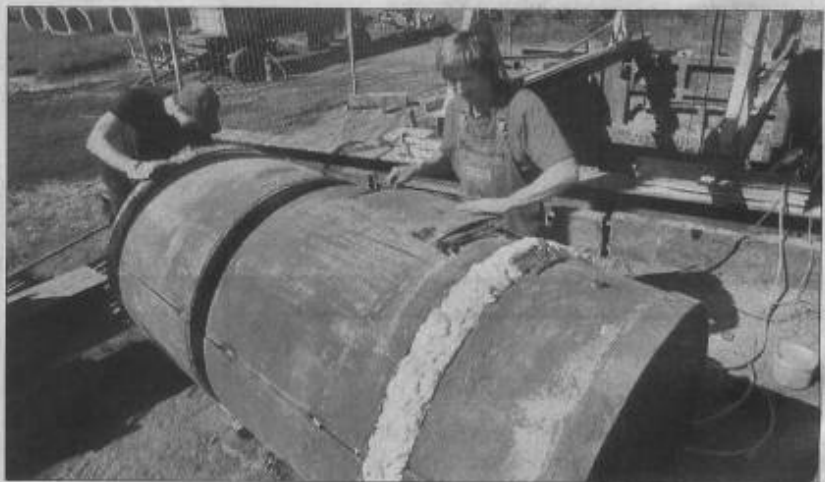
Mitarbeiter der Marsberger Firma ARS Rohrvortrieb bereiten den Bohrkopf vor, der sich unter der Straße durcharbeiten soll. MZ-Foto: Frank Gehrmann
