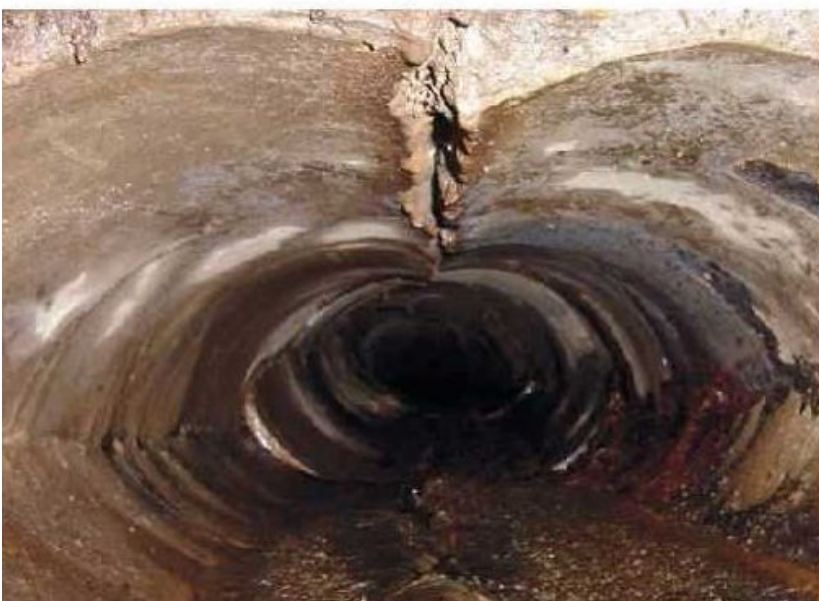
Schadensbild der Verrohrung
